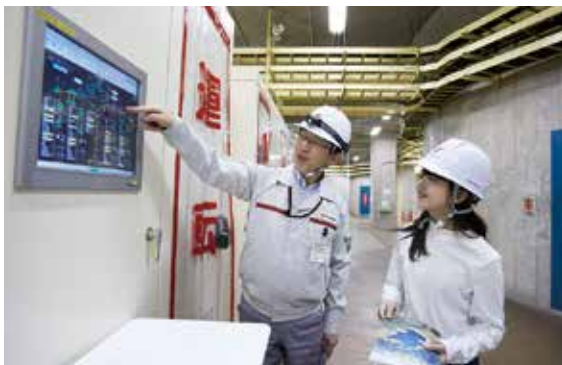
全発電機を制御する重要な装置「シーケンサー」。制御盤には、揚水の時と発電の時と違う電気の流れなどが表示されます。
