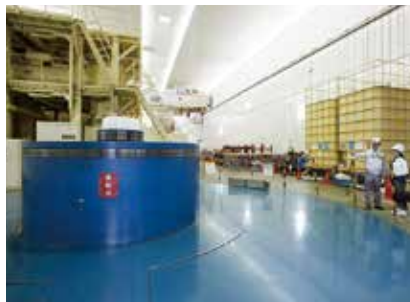
地下1階の組立室。25万kWの発電機を4台設置。
