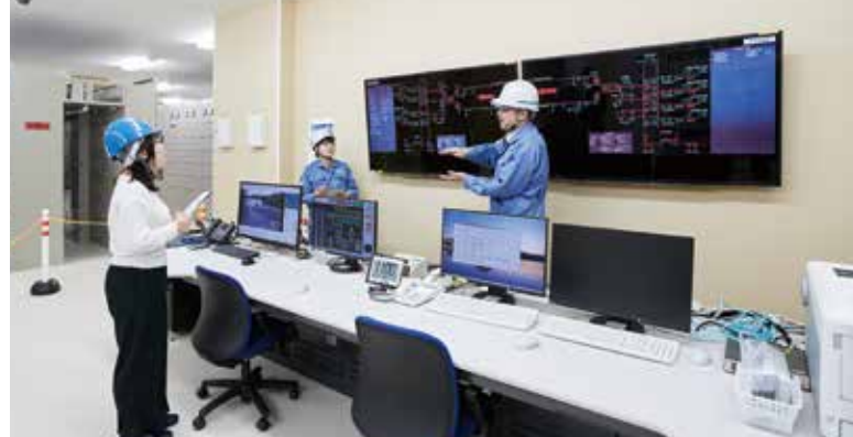
制御室の監視制御システム。通常は函館支店の系統制御所で24時間遠隔で監視制御されている。「北海道から本州へ電気を流す場合は“南流”、その逆は“北流”と呼ばれます。矢印の向きで分かるんですよ」と説明を受ける佐々木さん。
