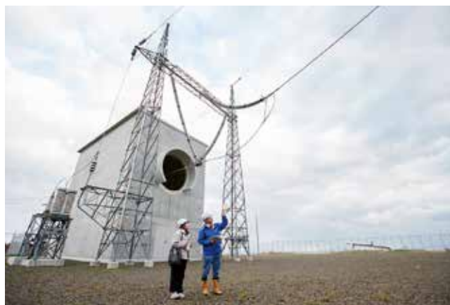
吉岡ケーブルヘッドの遮風建屋。北斗変換所からの送電線はここから斜坑を通り、青函トンネルへ本州へと繋がります。
