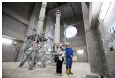
ケーブルヘッド(写真中央にある棒状の設備)がある建屋内。壁には工事の様子が掲示されています。
