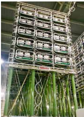
多段に積み重ねたバルブホール内の交直変換器。
