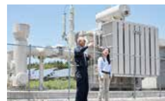
太陽光発電所内の変電施設。ソーラーパネルで発電された電気は変電設備を通じて地中送電線に接続される。
