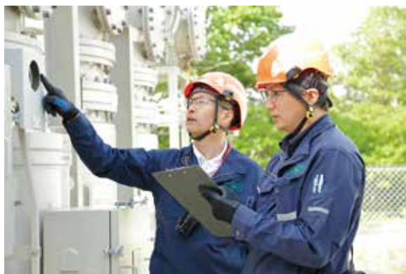
変電所の点検も2人体制で、計器の数値に異常がないか、一つひとつ声がけ、復唱しながら確認していきます
