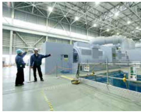
1号機のタービン前にて「2021年の地震の際には、揺れにより分厚く頑丈な金属製のタービン軸受台が曲がって破損しました」と説明がありました
