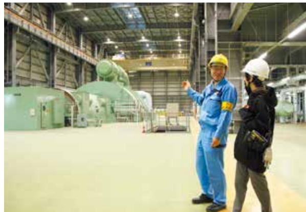
左手奥に見えるのは3号機のタービン。石炭火力として世界最高水準の熱効率約46%（低位発熱量基準）を達成し、二酸化炭素排出量の削減に寄与しています。
