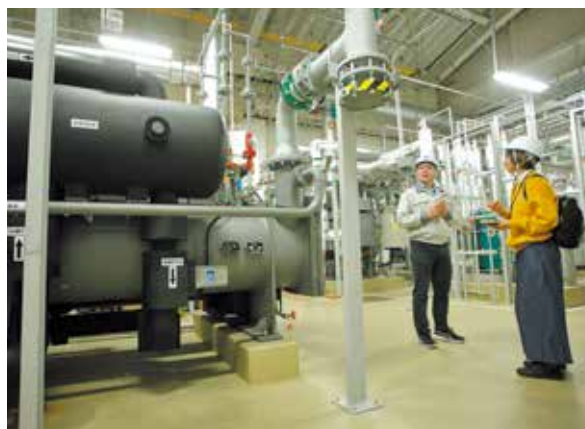
核融合研究開発のキーとなる原型加速器が機能を発揮するためには、冷却装置の働きが重要と説明を受けました。
