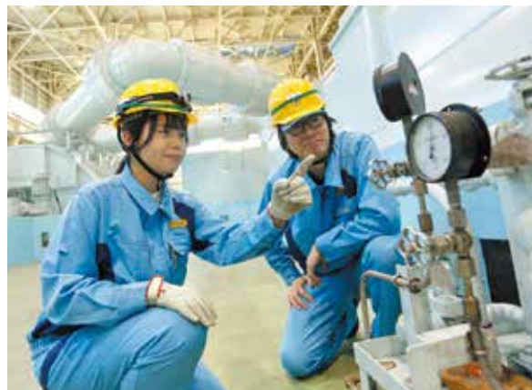
現場に向かいの日々の点検も、重要な業務です。タービンのそばにあるメーターを指差し確認！
