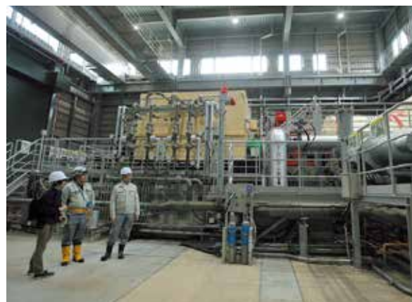
発電機と蒸気タービン、これまで見学してきた火力発電所のものと比べるとかなりコンパクトなサイズです。
