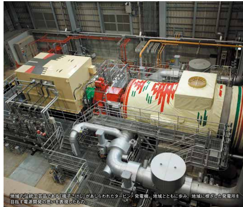
鬼首地熱発電所 (宮城県大崎市)
