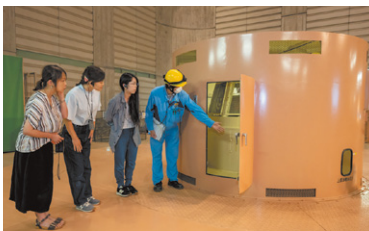
水車の真上に位置する発電機
