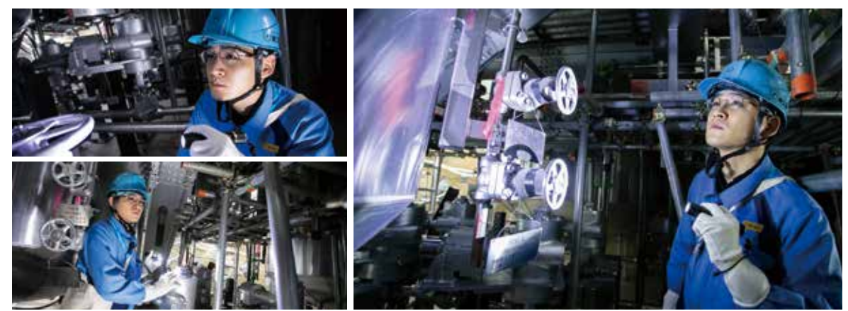
フィルタ付格納容器ベント装置の点検を行う久保さん。原子力部門の魅力を「工事の規模が大きいのと、それに最初から最後まで一貫して関わること」と久保さんは話します。
