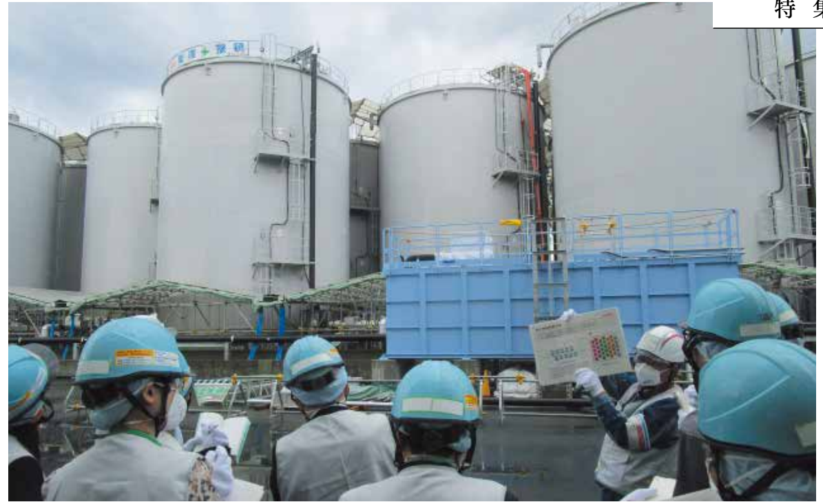
台湾の原子力関連専門家による福島第一原子力発電所 K4タンク群視察の様子（撮影日2023年6月16日） 出典：東京電力ホールディングス
