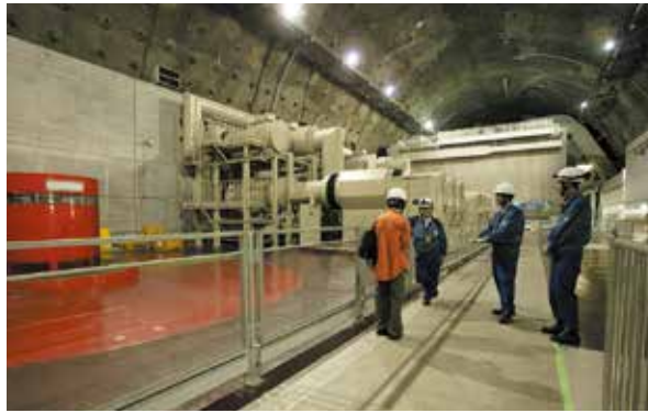
巨大なダム2つと、地下500mに造られた巨大な空洞に設置された発電機。土木と電気、両方の知識がないとその全容を把握することは難しくそうです。
