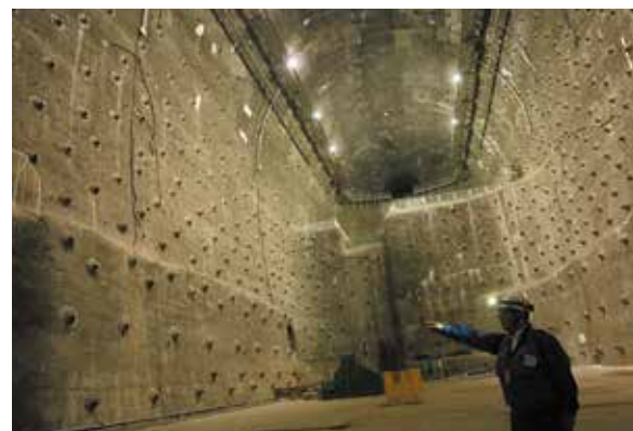
3~4号機を設置予定の大空洞。幅33m、高さ52mの卵型のトンネルの壁面には強度を増すために、PSアンカーと呼ばれる鋼線が多数打ち込まれています。
