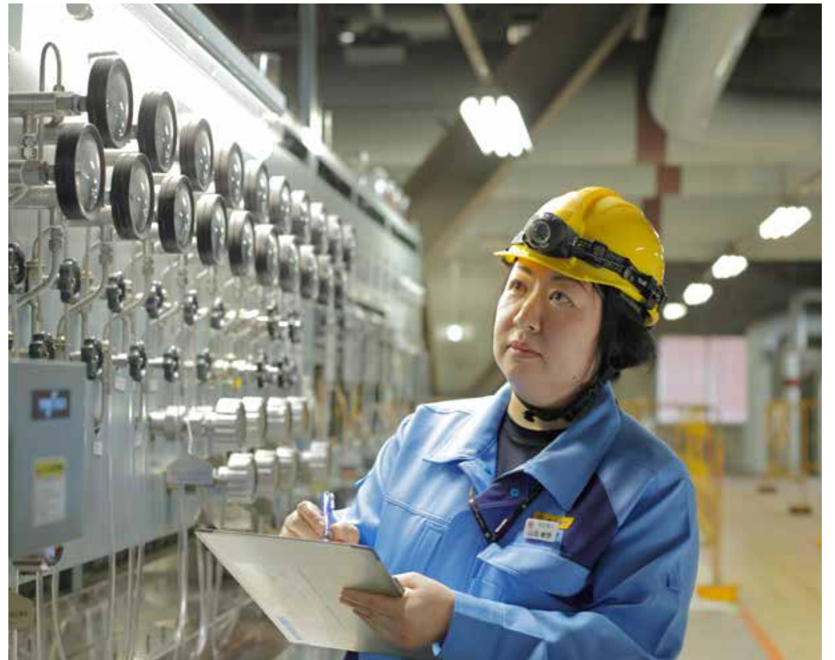
発電所のボイラー水や蒸気が採取できるサンプリングラック（試料採取装置）を確認する山田さん。これらの発電用水を分析し、必要に応じて水質管理値に収まるように薬品の投入などの対処を行います。
