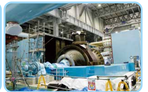
蒸気タービンは外装が外され、タービン翼が見えていました。蒸気タービンに対して復水器を水平に配置。従来のように垂直に配置するのと比較して建屋の高さを低くでき、建設コストの削減につながっています。
