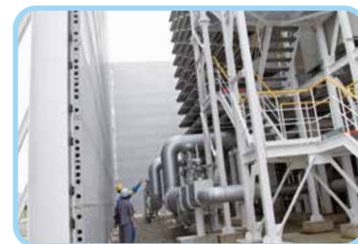
海風による着雪や凍結を防ぐために、空気取込口には北西向きに壁が設置されています。
