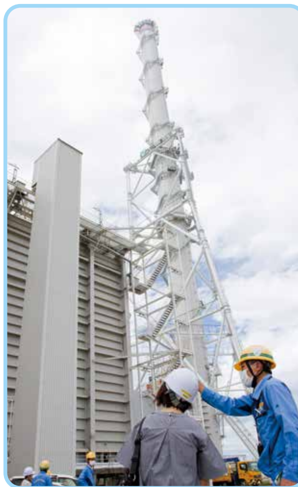
煙突は高さ136mで、強度計算された支持鉄塔は煙突の中程までを囲んでいます。支持鉄塔と煙突の間には、耐震のためのダンパーが取り付けられています。
