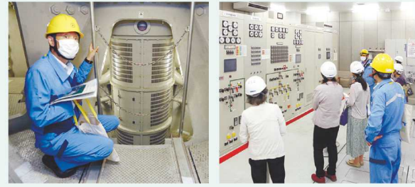
(左)豊実発電所は2013(平成25)年に改修され、水車の型式が変わって発電効率がアップ。(右)普段は会津若松市にある水力運用センターから遠隔で運転・監視が行われている
