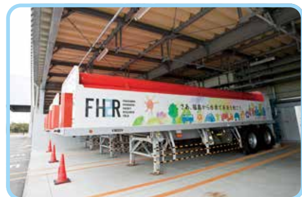
貯蔵された水素は200気圧まで圧縮されてから、水素トレーラーやカードルに注入され、使う場所へと運送されます。トレーラーは水素ステーションではそのまま、水素タンクとして利用されます。
