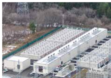
西仙台変電所 蓄電池システム (写真提供：東北電力)
