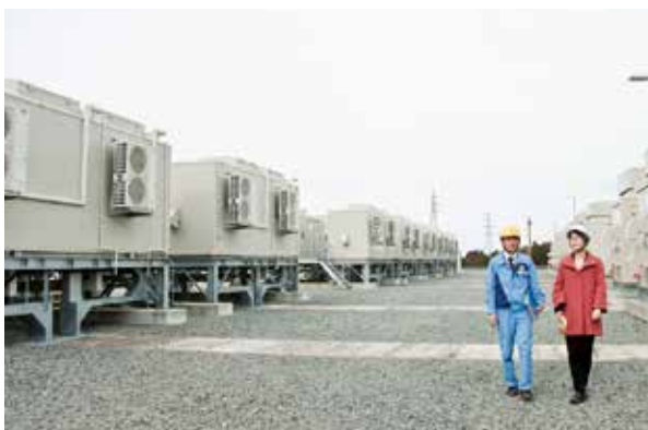
配線工事など作業効率化のため、高床の架台に設置されたPCSコンテナ。
