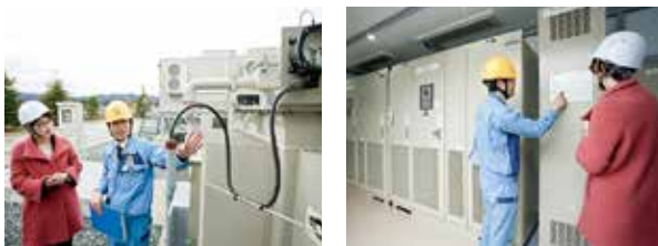
PCSコンテナ内部。PCSはパワーコンディショナ。蓄電池の直流電力を交流電力に変換する装置。
