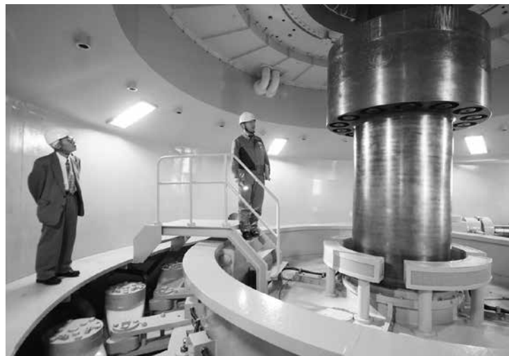
写真② 水車室 (上部：発電機、下部：水車)
