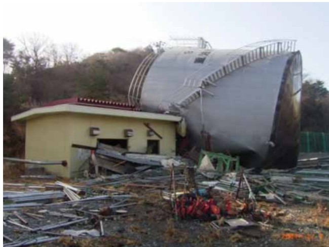
倒壊した重油貯蔵タンク (倒壊時の貯油量：約600kl)
