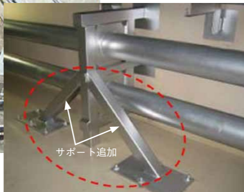
サポートが追加された配管
