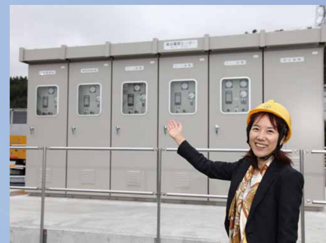
「高台電源センター」にある高圧電源盤。緊急時にケーブルで接続できる6台の電源車も、この高台に配備されている
