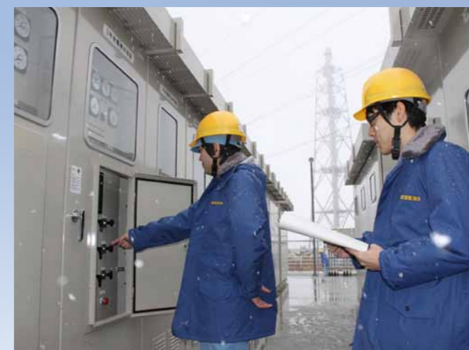
雪の降るなか実施した大容量電源装置の起動訓練
