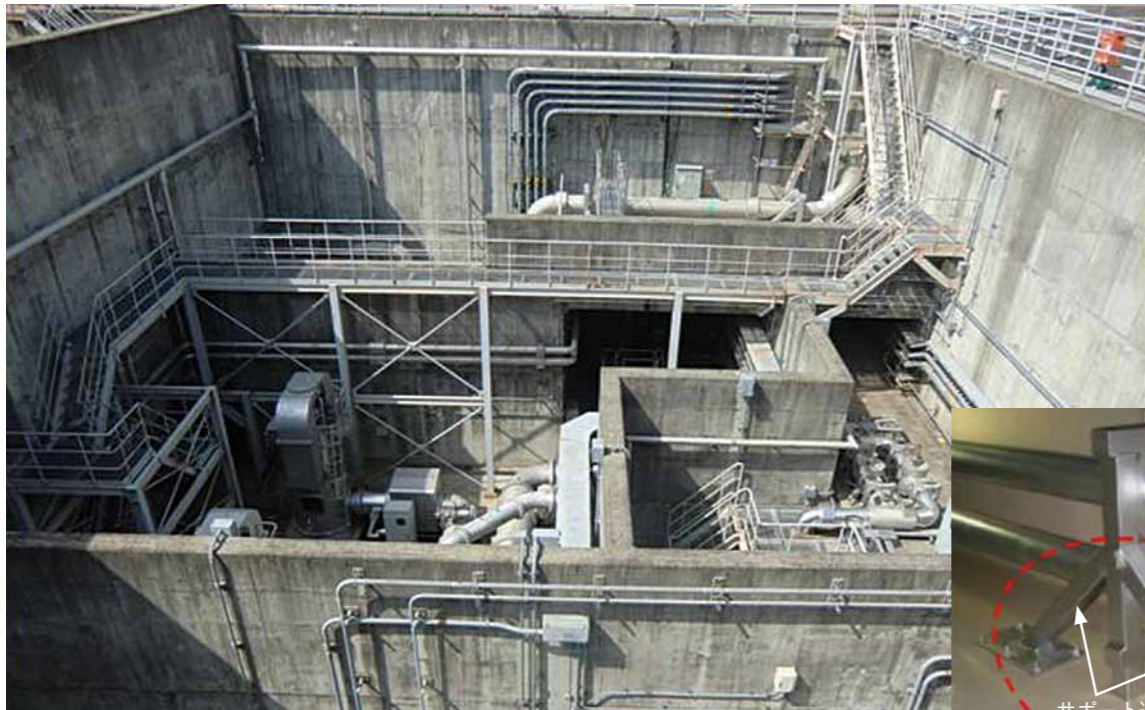
ピット化された海水ポンプ室
